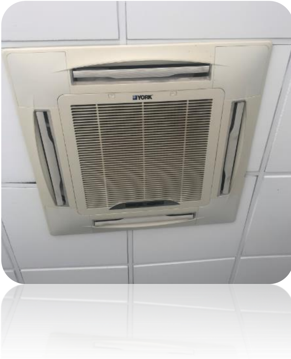
Figura 7. Aire acondicionado tipo cassette.
