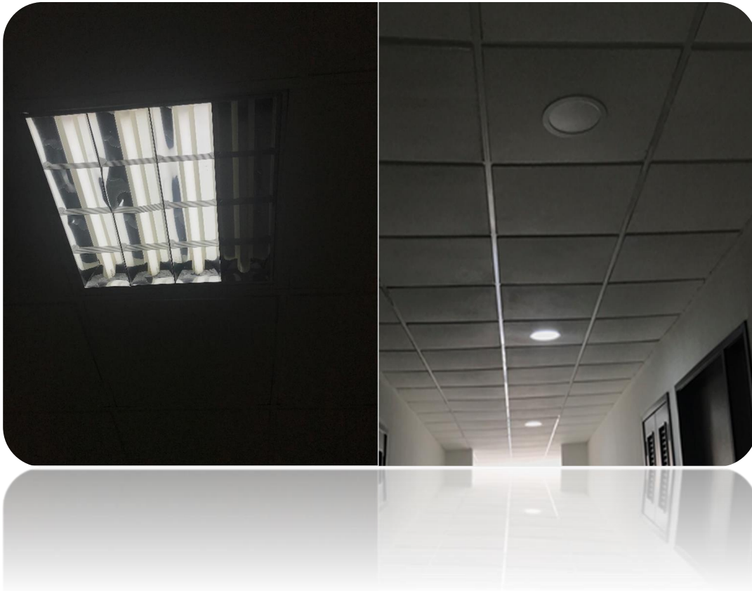
Figura 5. Luminarias en mal estado.
