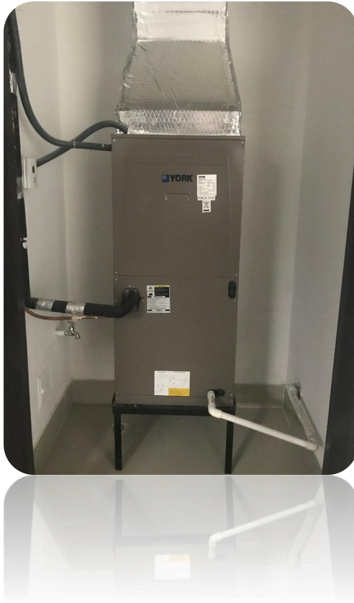
Figura 6. Aire acondicionado tipo central.
